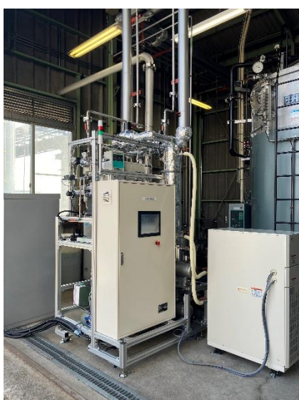
<CO 2 回収装置>
